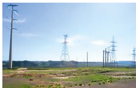
Figura 4. Vista geral de linha de transmissão.
