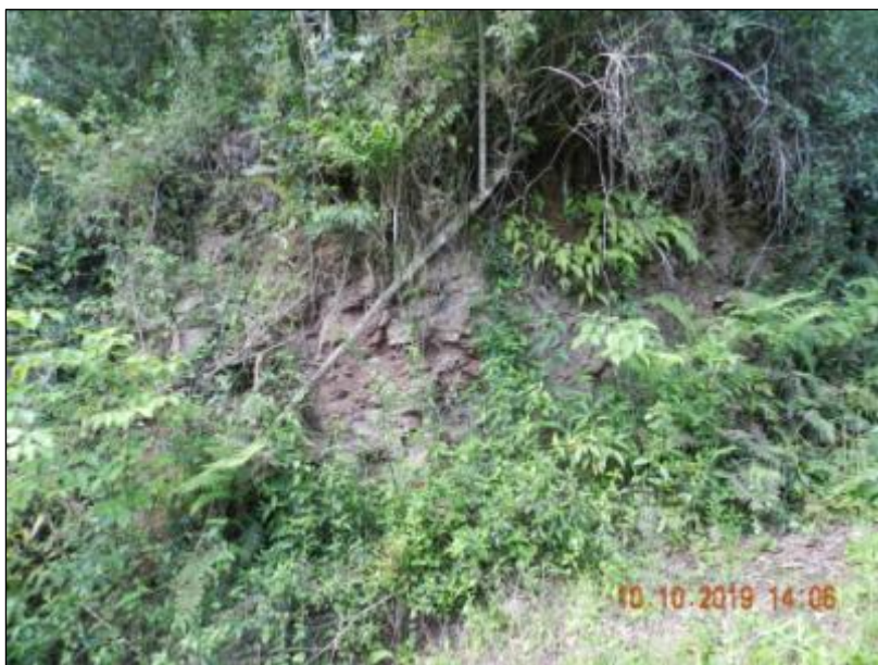
Foto 2: Talude de rocha alterada coberta por colúvio de cor marrom com presença de disjunções predominantemente horizontais, pouco espalhadas na base do talude.
