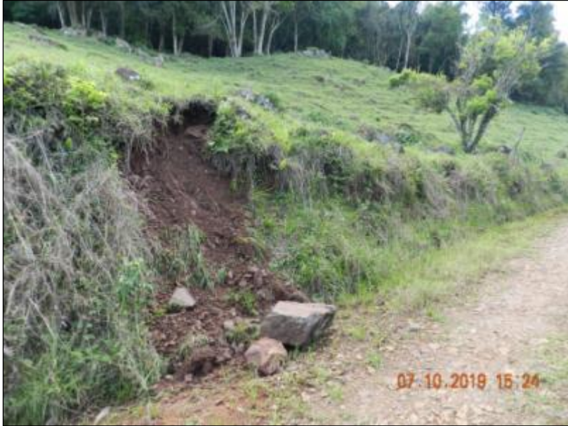
Foto 17: Talude íngreme em estrada local evidenciando a "cicatriz" de escorregamento circular de bloco de rocha.
