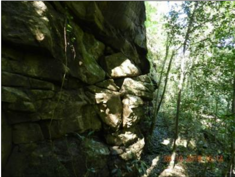
Foto 19: Quedas e escorregamento planar nos paredões rochosos em afloramento de rocha sã.
