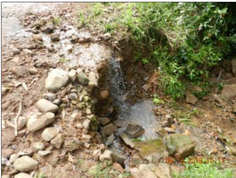
Foto 22: Ponto de passagem sobre estrada local com queda d'água causando uma remoção lenta do solo e de pequenos blocos de rocha na área da queda.
