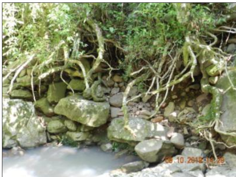
Foto 10: Depósito alúvio-colúvionares na margem direita do Arroio do Leite, caracterizada por solo e blocos de tamanhos variados de rocha, trazidos pelas enxurradas envolto em material fino argiloso.
