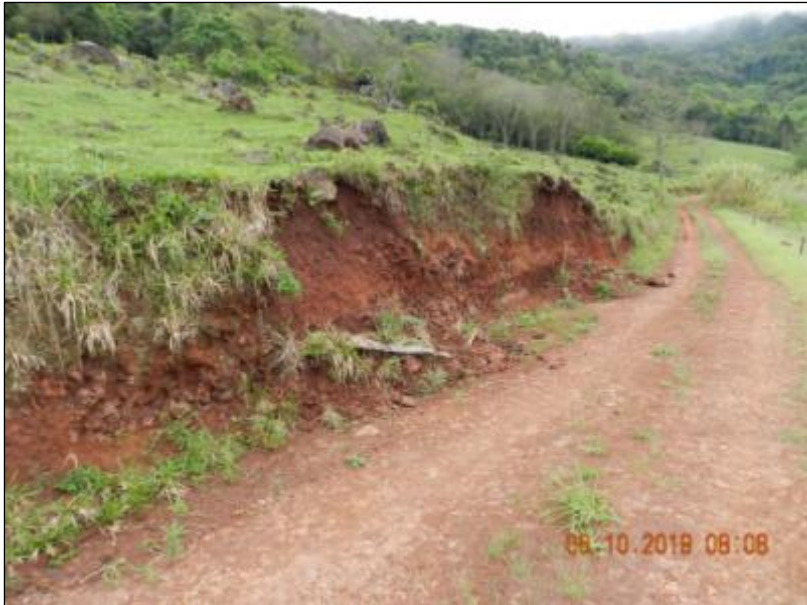
Foto 21: Escorregamento em talude nas estradas locais.
