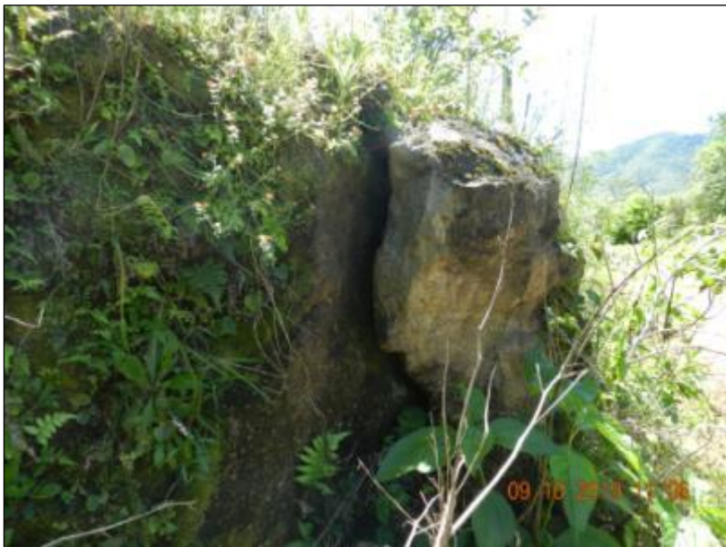
Foto 18: Escorregamento planar mostrando um bloco se despreendendo de talude em corte de estrada local.
